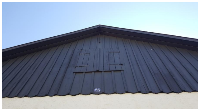
Abb. 35: Holzverkleidung an der Nordfassade. Unter dieser bestanden Hohlräume, welche aufgrund der vorgefundenen Sekretspuren von Fledermäusen genutzt wurden.
