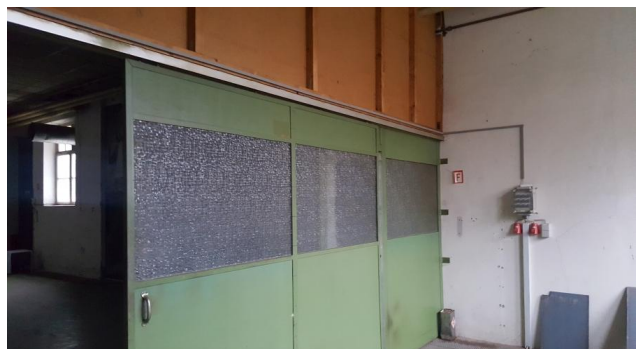
Abb. 18: Dicht schließende Türen im Eingangsbereich.
