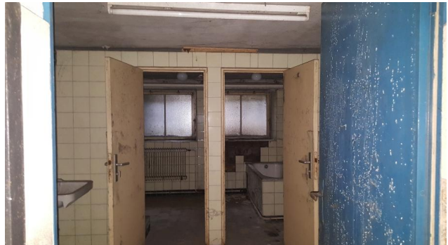
Abb. 16: Waschräume im Keller mit teilweise gekippten Fenstern
