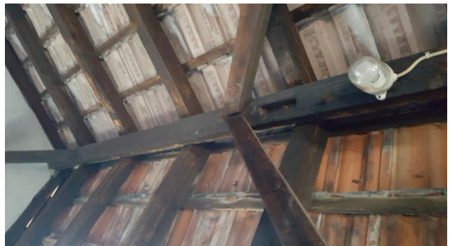
Abb. 33: Pfette im Dachstuhl. Unterhalb von dieser war Fledermauskot vorhanden.
