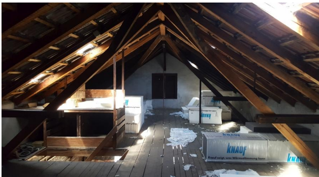
Abb. 32: Ansicht des Dachstuhls. Dort wurde an verschiedenen Stellen Fledermauskot gefunden.
